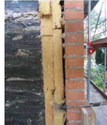
Beispiel: Sanierung einer zwei- schaligen Außenwand, Entfernen des Verblenders, Dämmung (Kerndämmung), Neuverblendung
